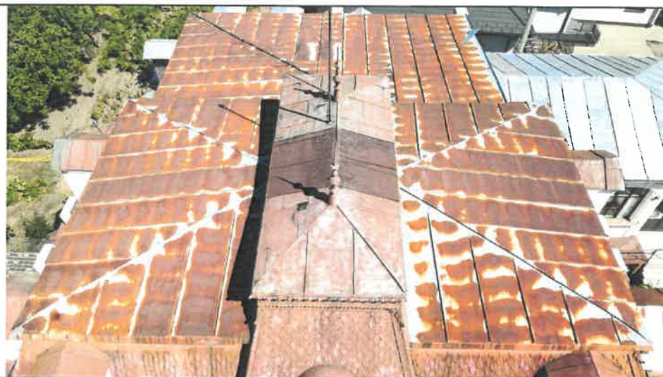
Fig. 5 – Degradari ale invelitorii din tabla
