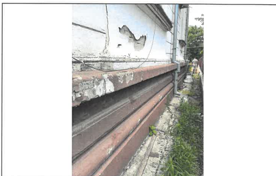
Fig. 4 – Degradari soclu si tencuiala
