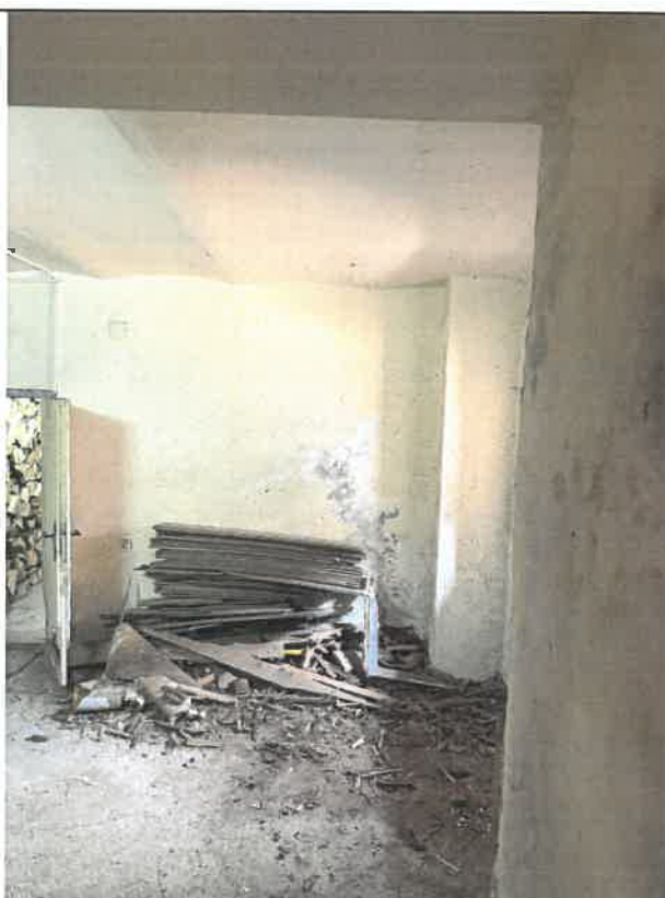
Fig. 6 – Degradari cauzate de infiltratii la nivelul peretilor subsol
